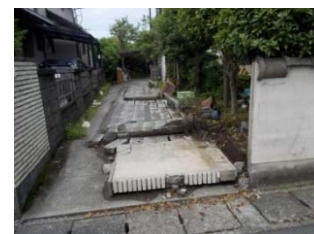
地震時のブロック塀倒壊事例 (東京都葛飾区)
