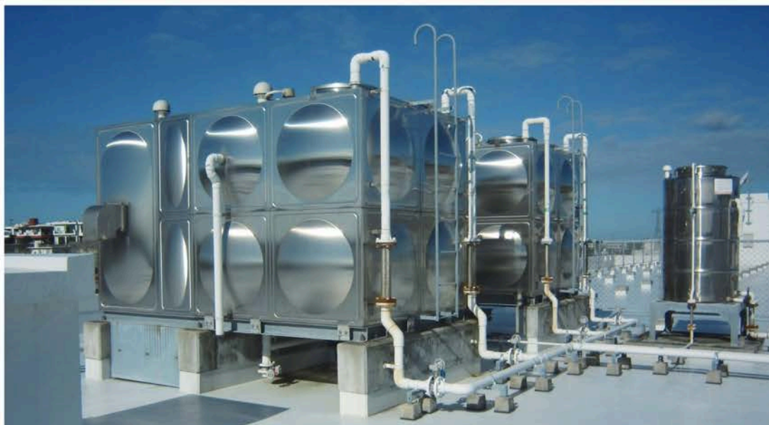
↑ ア がっこう なか すいどうかん じゅすい 学校の中にある水道管と受水そう
