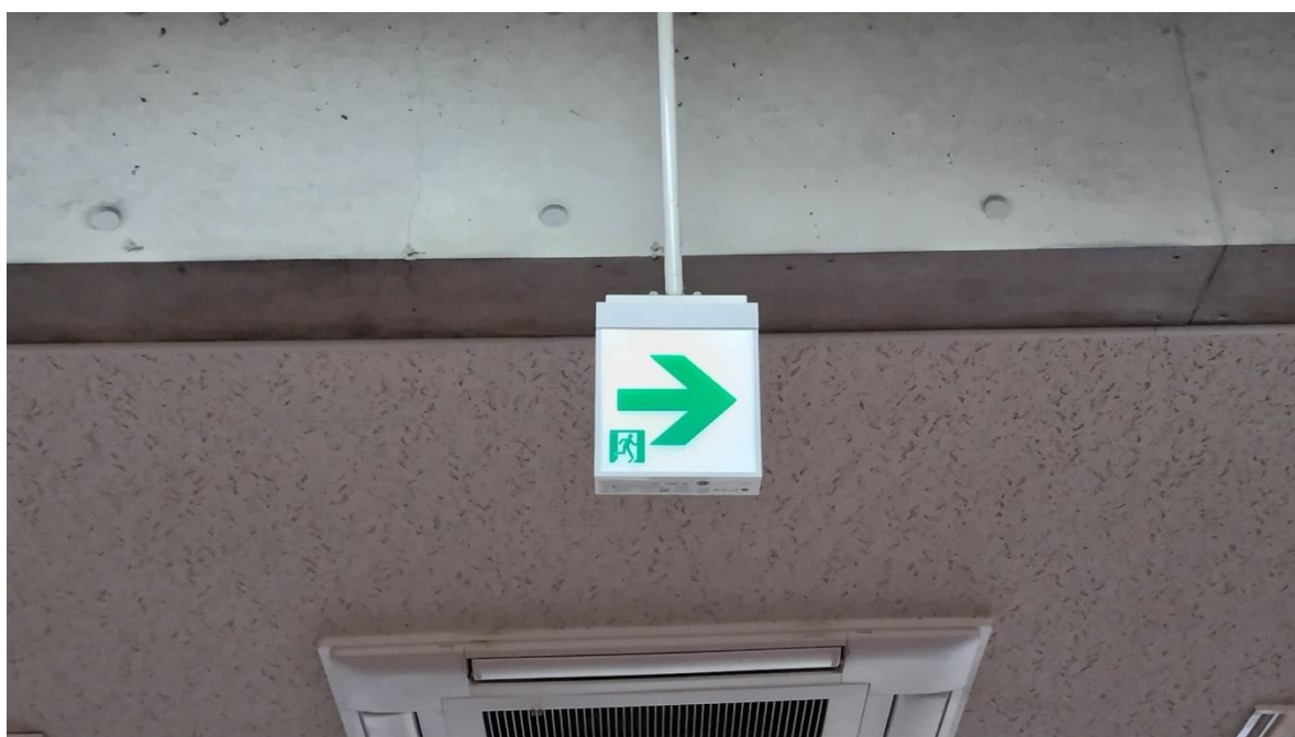
⑦通路誘導灯 数量：2 台
