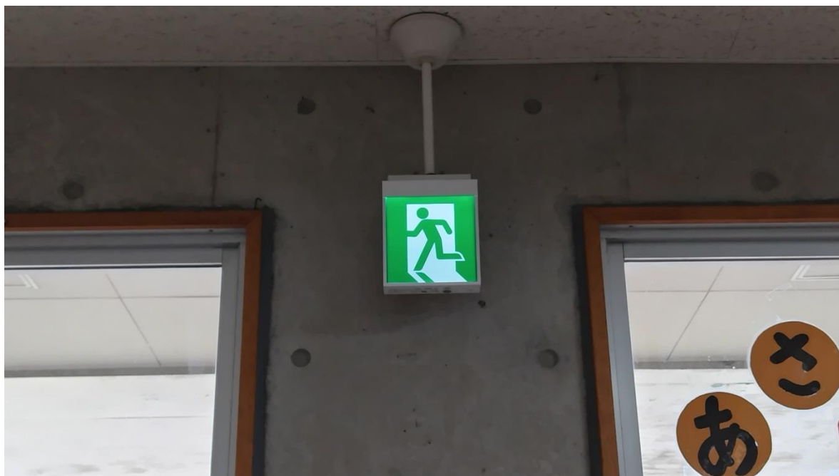
⑥避難口誘導灯 数量：1 台
