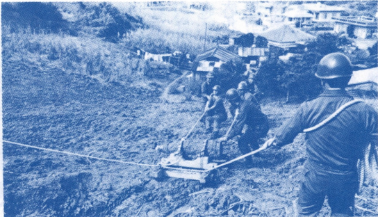
▶一月二十七日午後、上原地内で発見された埋没不発弾の撤去作業が自衛隊不発弾処理隊によって行われた。不発弾は、口径三五センチ、弾長一〇センチ、重量三三三キログラムの米国製のもの。
