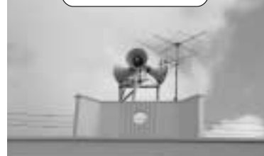
屋外放送設備
