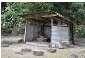
①修繕前の拝殿
