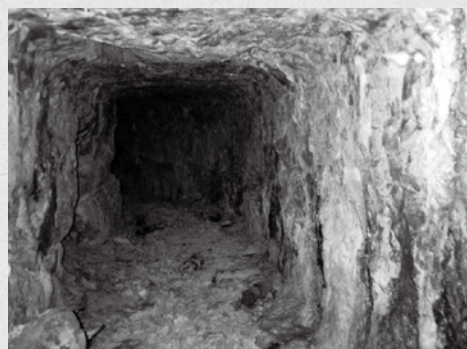
戦後掘り出された陣地壕。床に杭木片が散乱して いた。数日後、壕は斜めに落盤して崩れた。
