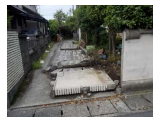
地震時のブロック塀倒壊事例 (東京都葛飾区)
