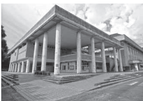
西原町町民体育館に雨漏りが・・・!! 公共施設への対応は大丈夫??
