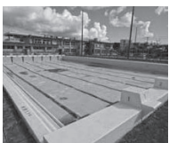
老朽化で使用中止の 西原中学校プール
