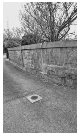
通学路上にある危険なブロック塀
