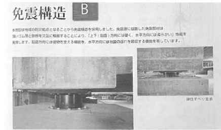
庁舎の免震構造
