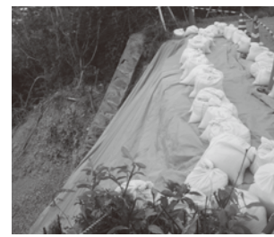
パークゴルフ場擁壁崩壊
