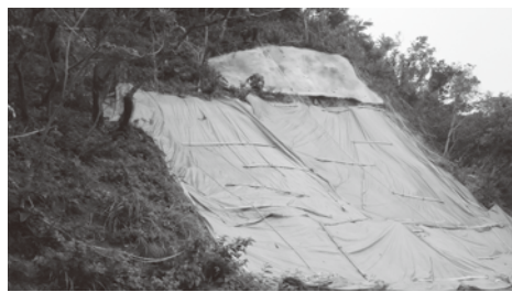
町道幸地翁長線土砂崩れ
