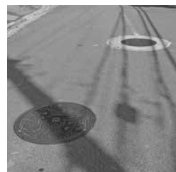
路面のマンホールのガタツキへの対応は？
