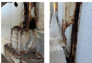
事務所鉄骨柱の腐食
