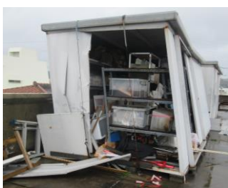
台風6号による倉庫損壊
