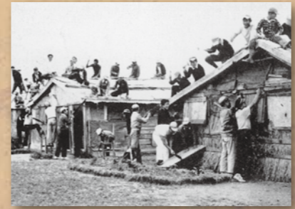
1953(昭和28)年 西原中学校(現・西原小学校敷地内)の校舎修理作業 お互いに協力しながら校舎の修理にあたっている生徒たちの表情は明るい。戦後の校舎は、空き地を利用した青空教室から始まった。
