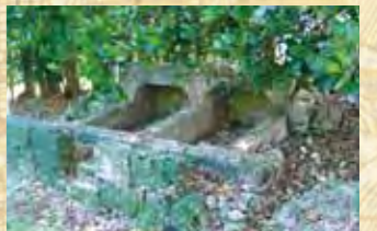
ウワーフル 棚原集落内にある宮里家跡に残された、ブタ小屋をかねた便所跡です。石積(いしづみ)でつくられた小屋のトゥーシヌミー(穴)から人が尿をたすと、ブタがそれを食べるしくみになっていました。
