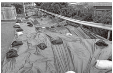
陥没した町道棚原1号線
