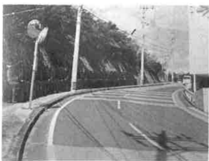
被災した道路擁壁(呉屋地内)
