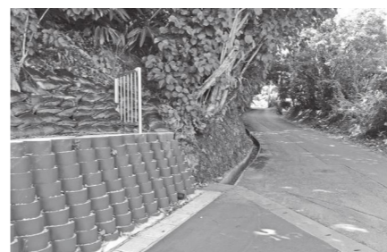
大雨であふれていた排水溝(桃原)
