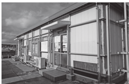
老朽化した町シルバー人材センター事務所
