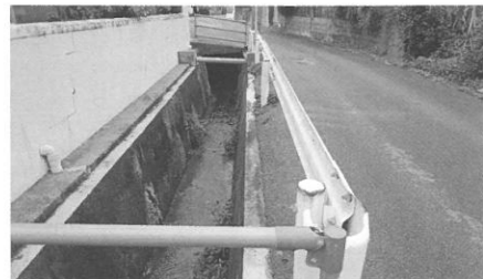
蓋がないため危険性が指摘されている排水路(美咲区)
