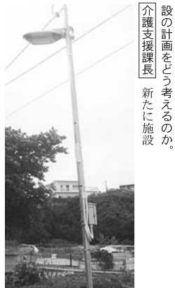
小橋川4号線の防犯灯
